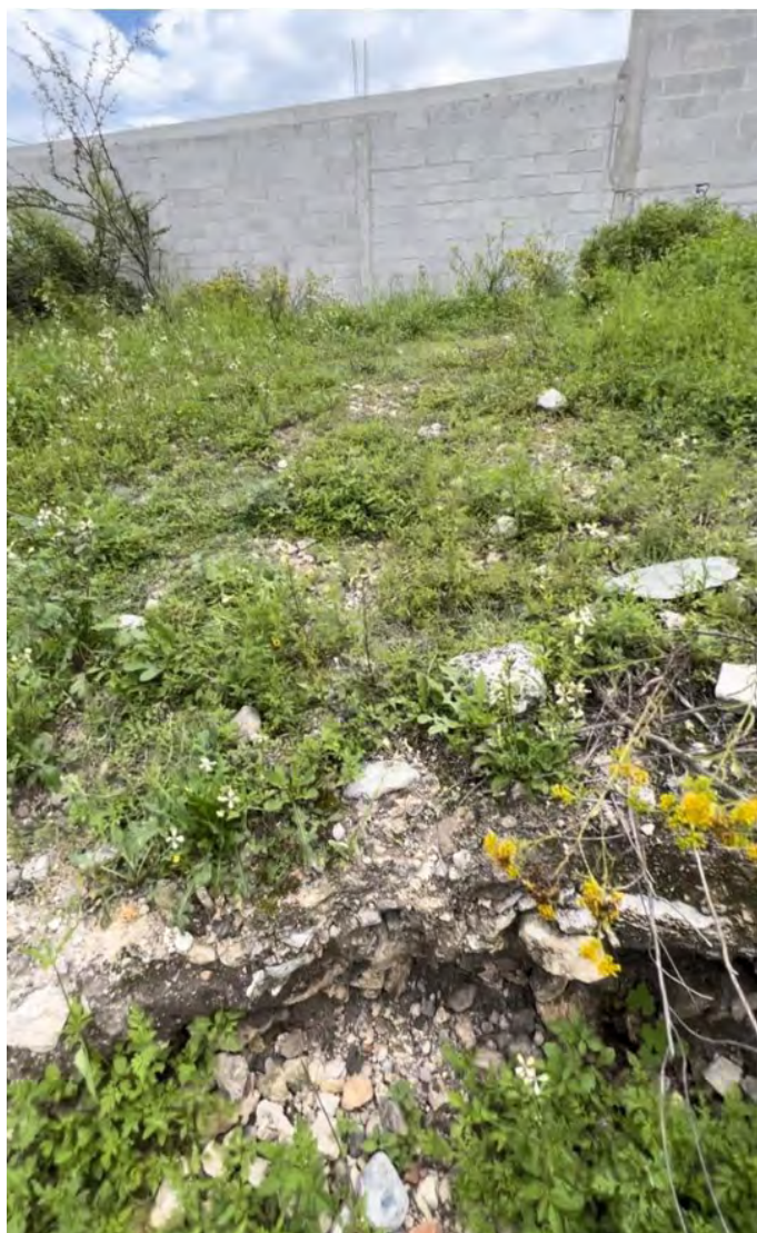
Fotografía 11. Desnivel de tetele expuesto debajo de un bardeado de tabique de concreto en la cabecera municipal de San Juan
